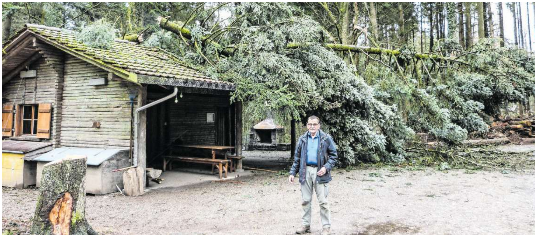
Hüttenwart Alois Erni zeigt, welchen Schaden der Sturm an der Heidelberghütte angerichtet hat. Bild: Kurt Lichtensteiger
