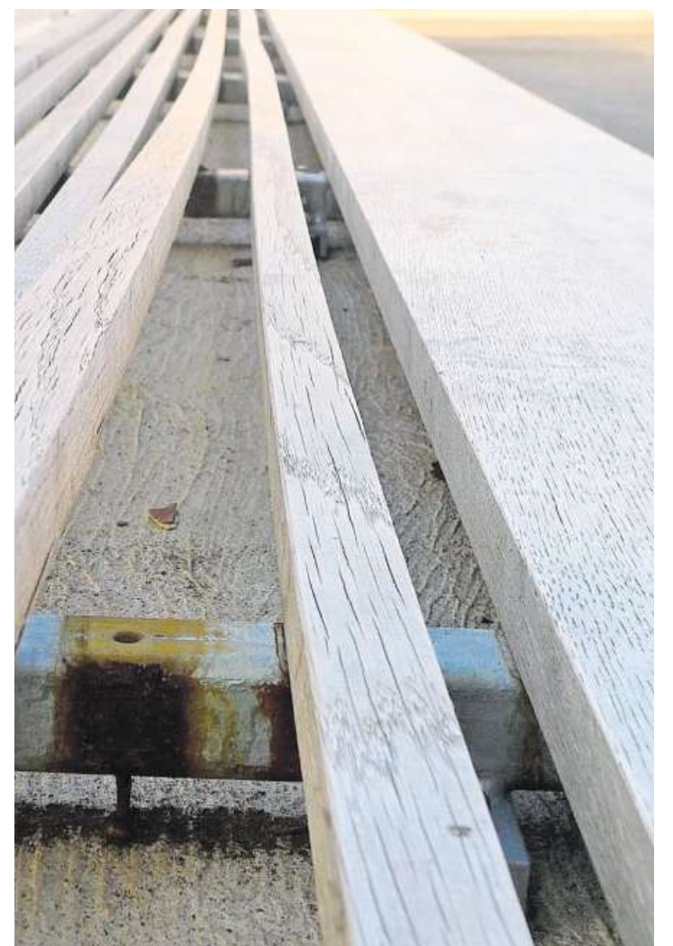
Defekt: Bei der Bank auf der Südwest-Seite, beim Migrolino, wurde eine Sitzrostplatte aus der Verankerung gelöst.
