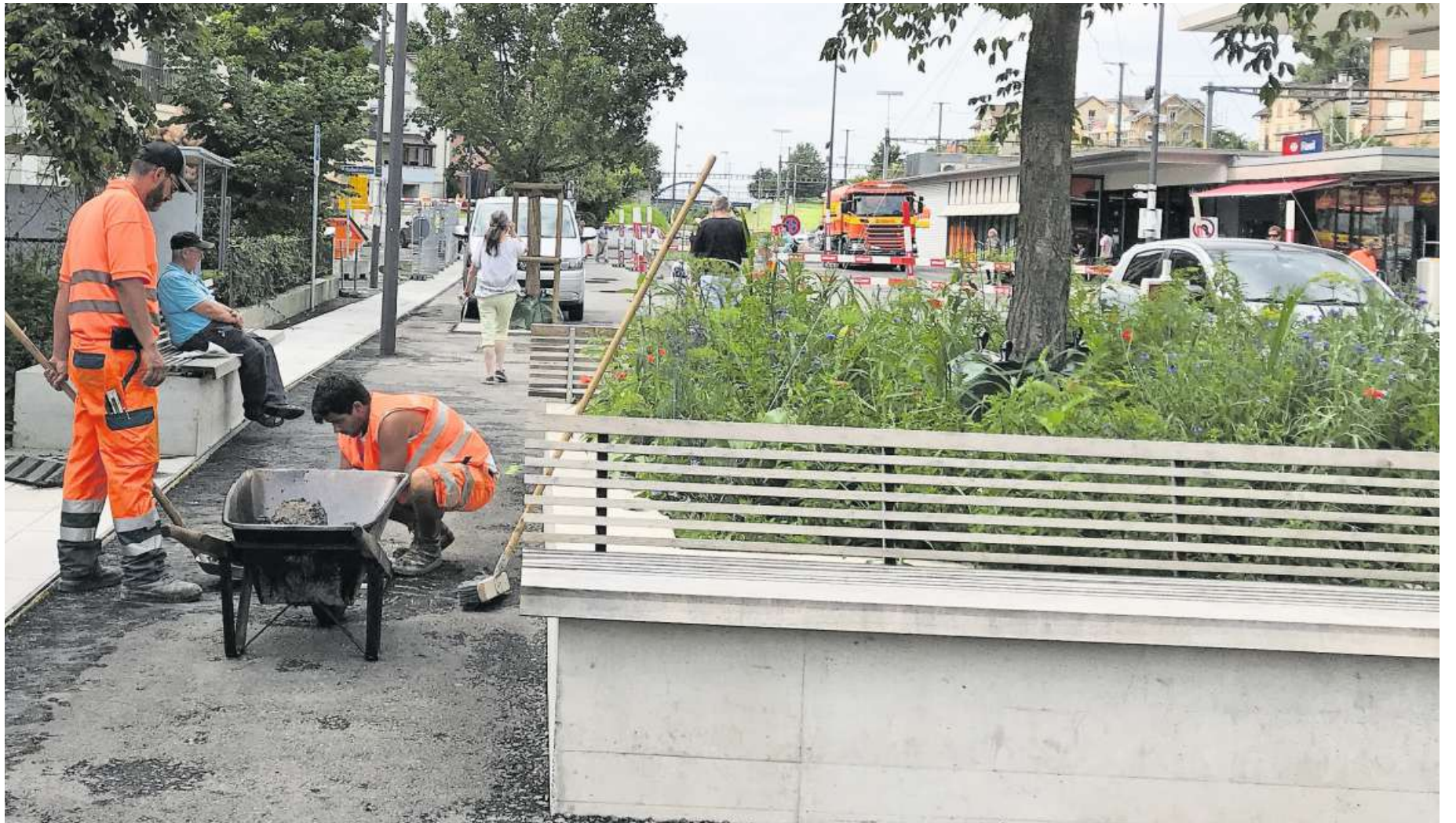
Vergangene Woche wurde der Deckbelag eingebaut. Die Auswirkung auf die Höhen der Ruhebänke ist unterschiedlich, mehrheitlich aber nicht ausreichend. Bilder: Andrea Häusler
